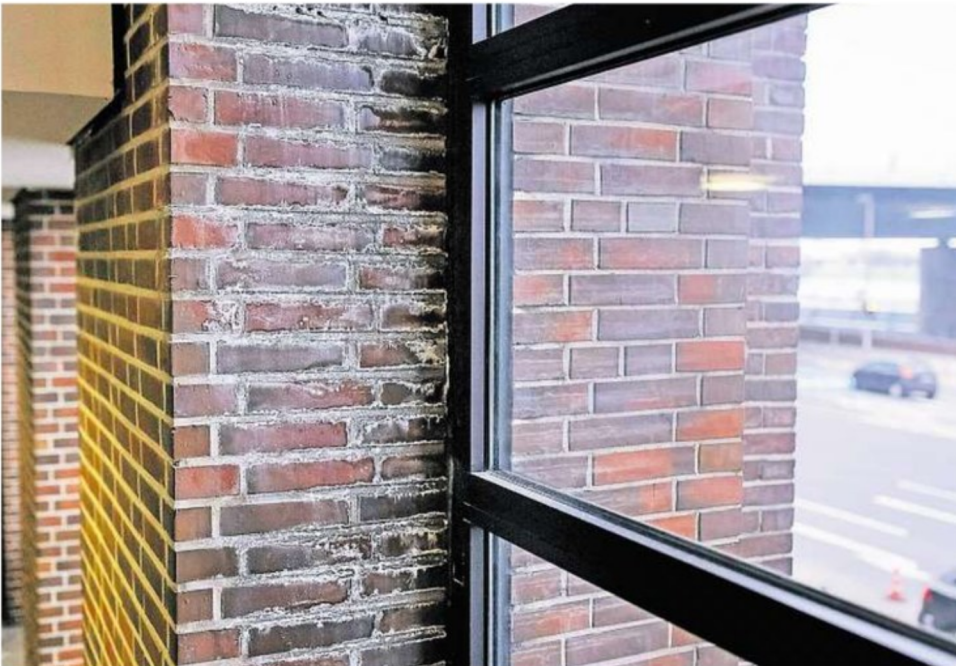
Die Fenster der Westfassade müssen ausgetauscht werden, es dringt Feuchtigkeit ein.
